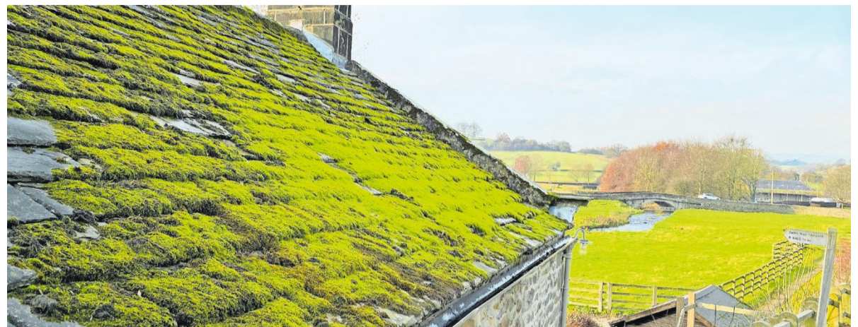
Moos auf dem Dach sieht nicht nur unansehnlich aus, sondern schadet auch den Dachziegeln. Professionelle Reinigungsfirmen übernehmen die Entfernung.
