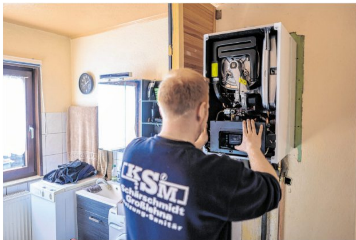
Die energetische Sanierung einer Immobilie erfordert viele Umbaumaßnahmen. Die Handwerker dürfen aber nicht mit den Arbeiten beginnen, bevor der Antrag auf Förderung gestellt wurde.
