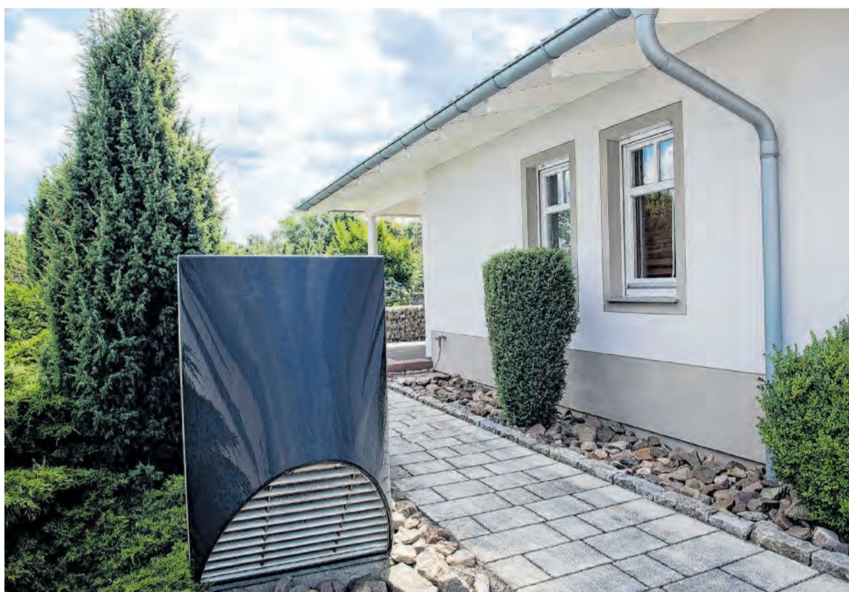
Die Wärmepumpe gewinnt Wärme aus dem Erdreich. Dieser Effekt ergänzt den niedrigeren Energiebedarf, den eine Flächenheizung im Vergleich mit üblichen Heizkörpern aufweist.
