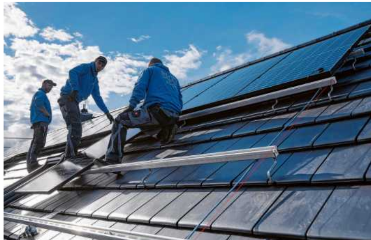
Wer eine PV-Anlage auf, an oder in der Nähe seines Eigenheims anbringen lässt, zahlt auf die Lieferung, den Erwerb und die Installation keine Umsatzsteuer mehr. Foto: Marjan Murat/dpa
