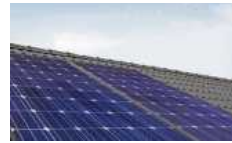
Fotovoltaik-Anlage auf einem Hausdach. Foto: HLC/Viessmann
