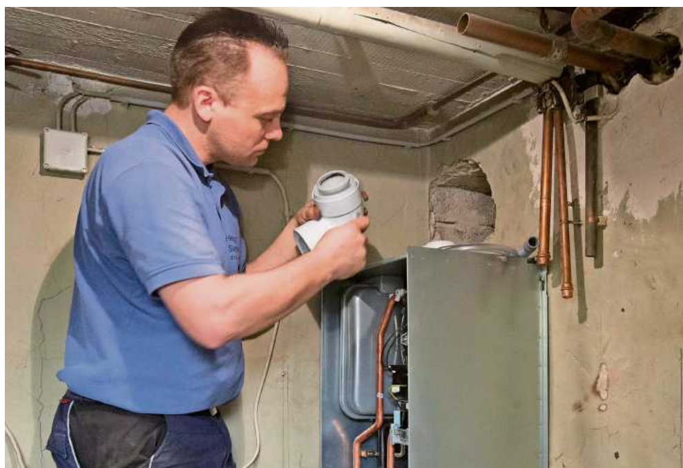
Bei der Installation eines Brennwertgerätes wird in den alten Schornsteinzug ein modernes Abgasrohr (im Bild in weiß) aus Kunststoff eingezogen. Durch die energiesparenden niedrigen Abstemperaturen ist der alte Schornsteinzug in der Regel uneeignet.
