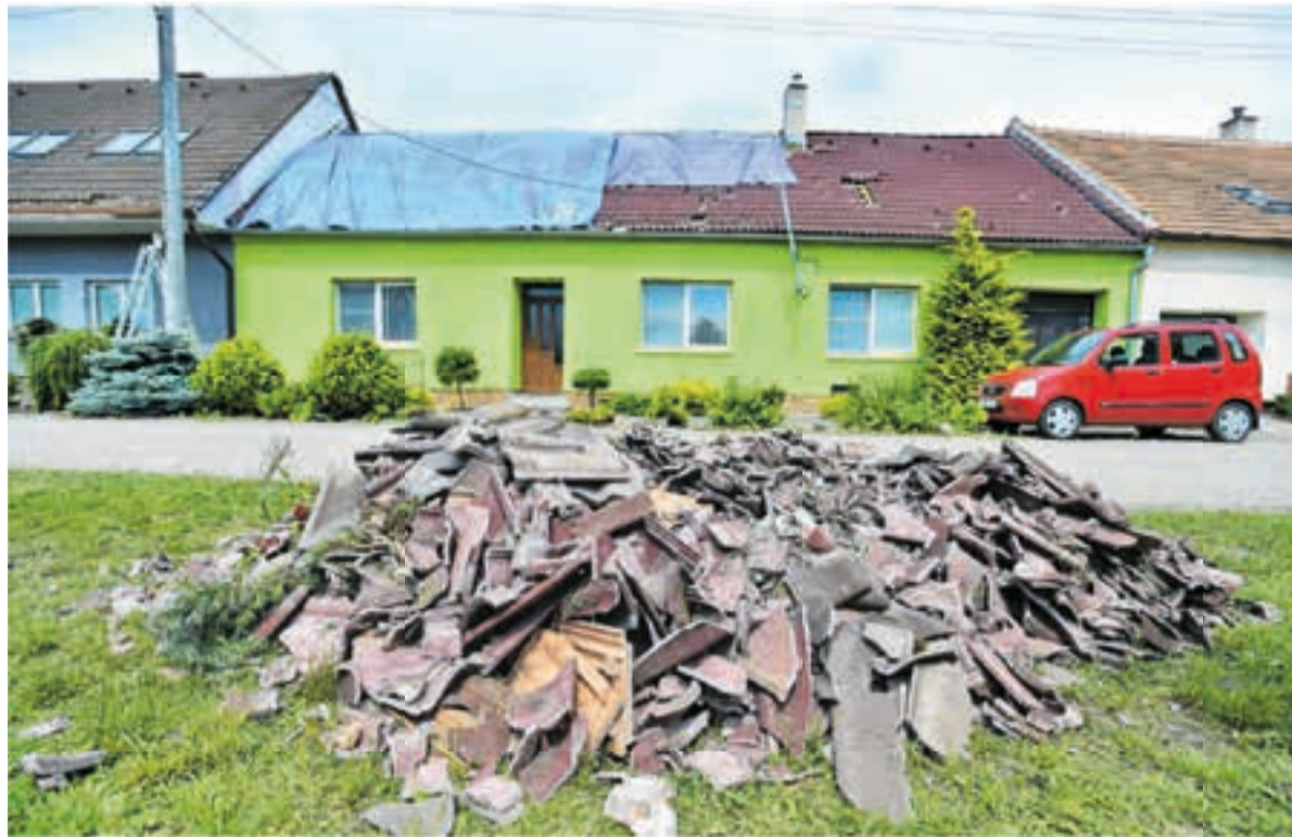
Auch der Zustand des Daches sollte regelmäßig überprüft werden. Kommt es bei einem Sturm zu Schäden, zahlt die Versicherung nur, wenn das Dach zuvor sorgfältig gewartet wurde.
