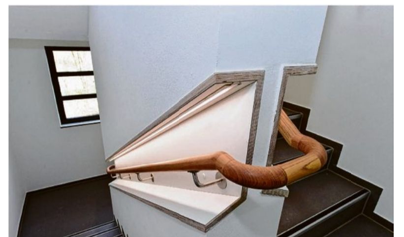
Beleuchteter Handlauf im Treppenhaus: modernes Designelement und zugleich ein Stück Sicherheit.
