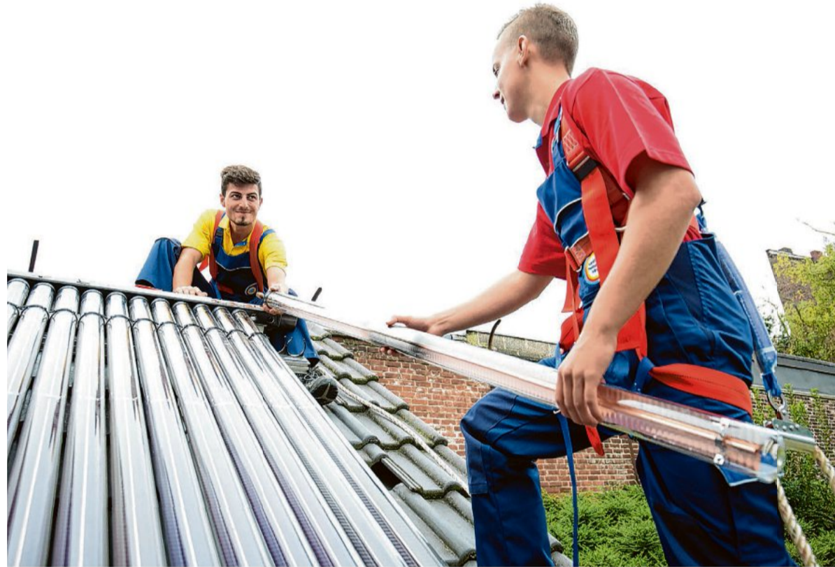
Hoch hinaus mit einer Ausbildung in der Sanitär-Heizung-Klima-Branche.
