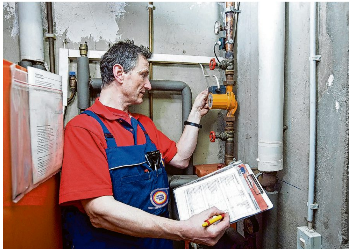
Der Heizungs-Check deckt auf: Der Stromverbrauch alter Pumpen liegt zehnfach über dem tatsächlich Notwendigen. Auch wird zu viel Wärme vom Kessel in die Wohnräume transportiert – eine doppelte Verschwendung.
