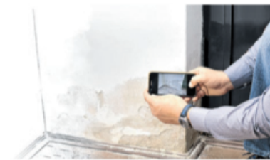
Feuchtigkeit im Keller. Foto: HLC/Remmers/@aleksandar29 – stock.adobe.com
