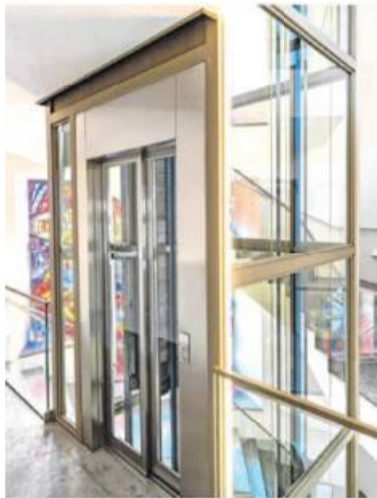
Mit dem neuen Aufzug im Treppenhaus sind jetzt alle Stockwerke barrierefrei erreichbar.
