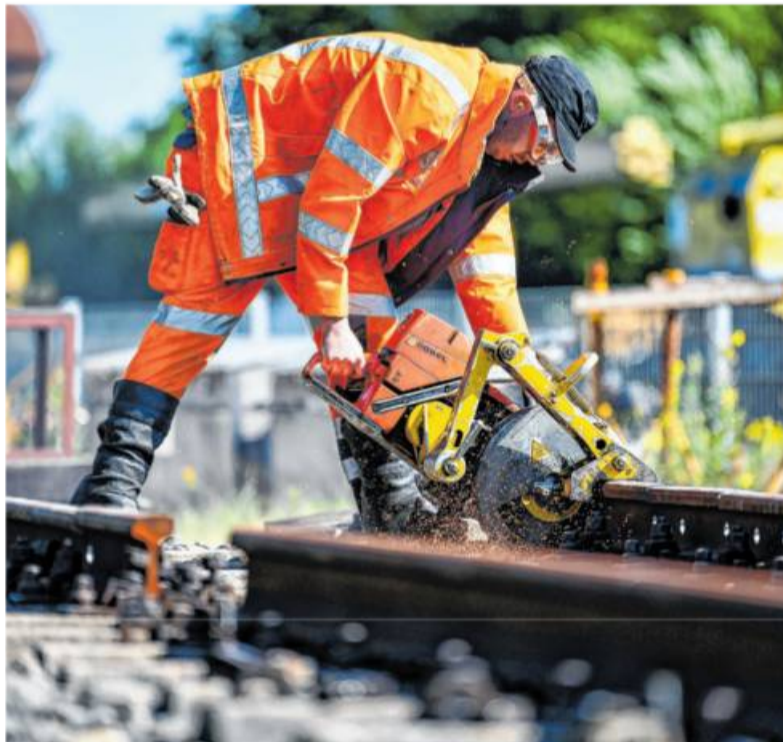
„Nichts für Einzelkämpfer“: Gleisbauer arbeiten im Team. Unser Foto zeigt den Auszubildenden Noah Klunte bei der Arbeit.
