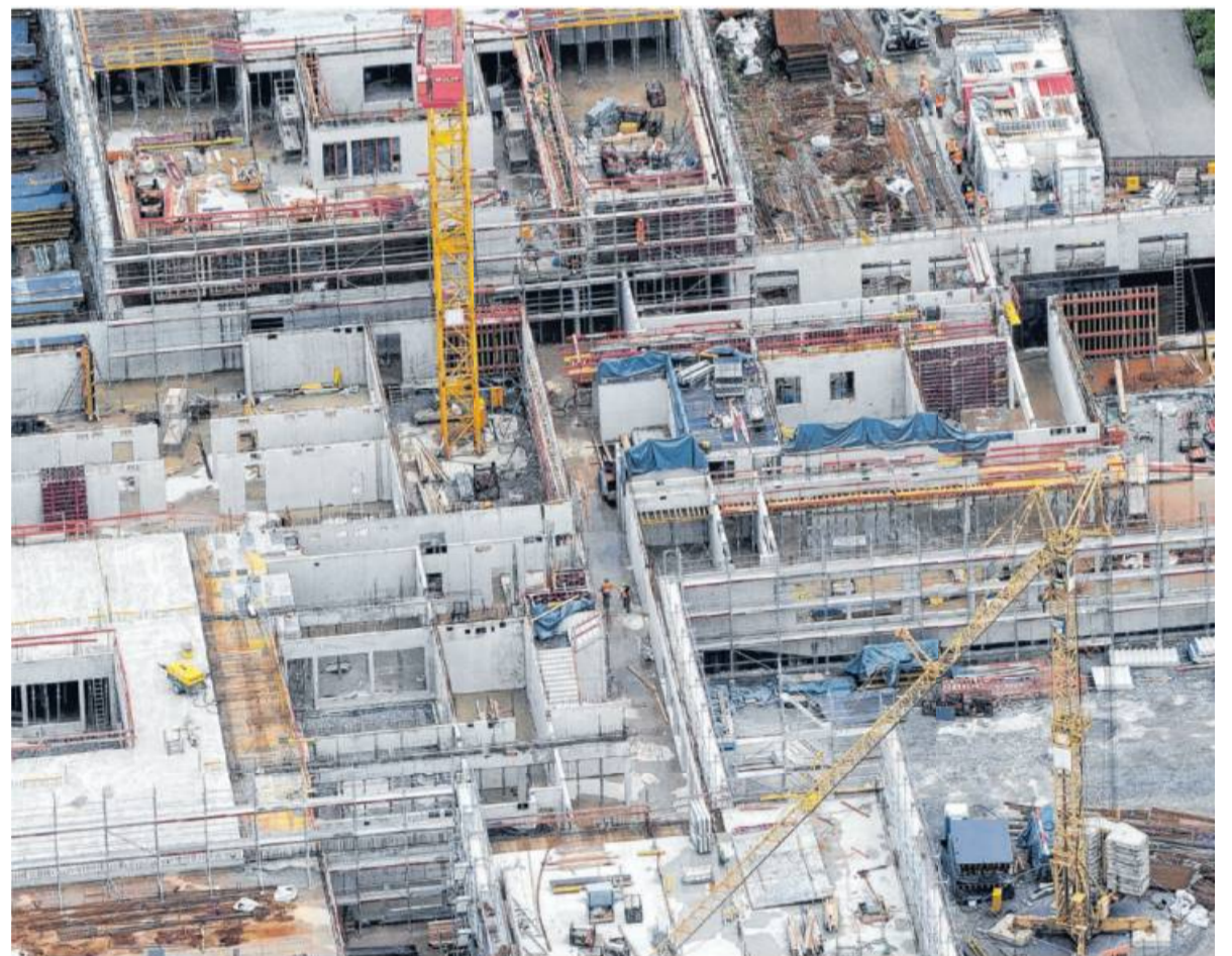
Die Rohbauarbeiten für den Neubau sollten eigentlich vertraglich Ende Juli abgeschlossen, das Richtfest ebenfalls im Juli gefeiert werden. Angesichts der Entwicklung dürfte das kaum realistisch sein. Foto: Werner Kuhnle
