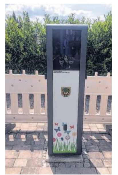
Die Ladesäule in der Markgröninger Straße wurde in Betrieb genommen. Stadt Asperg
