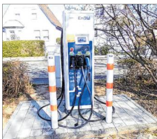
Die neue Ladesäule in der Bahnhofstraße.
