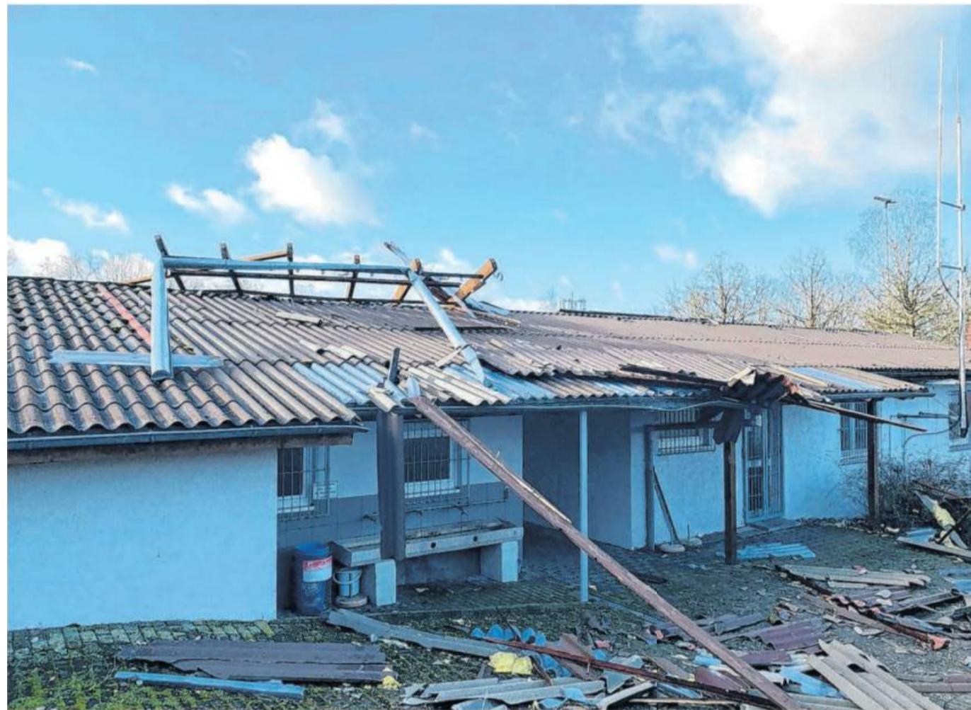
Auch in der Region verursachte der Orkan Sabine nicht unerhebliche Schäden.
