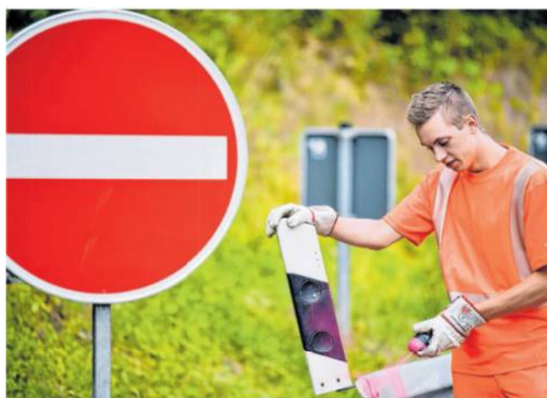
Wenn eine Fahrbahnmarkierung ausgebessert werden muss, ist Max Stahl zur Stelle: Der 17-Jährige macht eine Ausbildung zum Straßenwärter.
