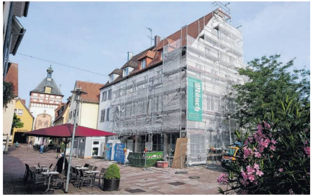
Eingerüstet: Am Filialgebäude in der Bietigheimer Altstadt am Ku(h)riosum wurde seit verganginem März außen und innen gearbeitet.
