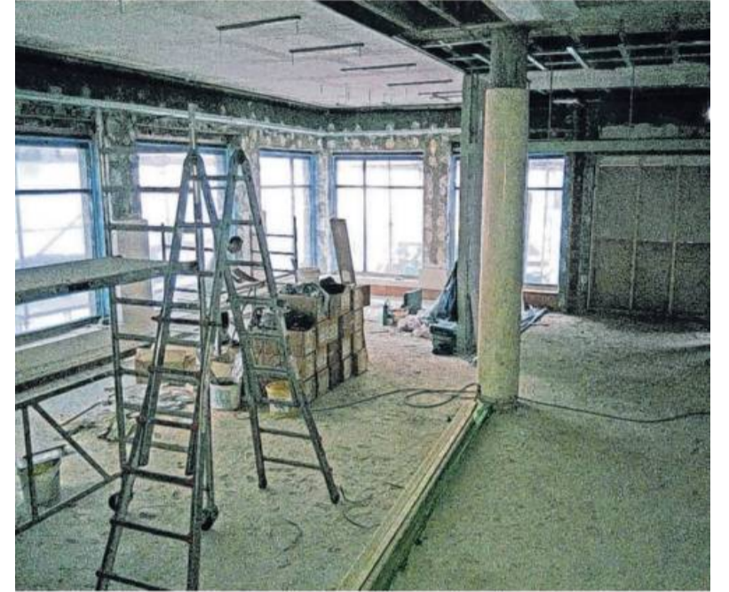
Noch vor kurzem waren die Räume der Filiale eine einzige Baustelle – am Freitag werden sie sich den Kunden und Besuchern in neuem Glanz präsentieren.
